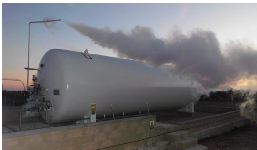
Foto 1. PSV en interior de arqueta (cerrada) en planta GLP con depósito enterrado Foto 2. PSV bajo capota (descarga bloqueada) en planta GLP con depósito aéreo Foto 3. Descarga PSV depósito GNL, con corte 45 ° en conducción de descarga
